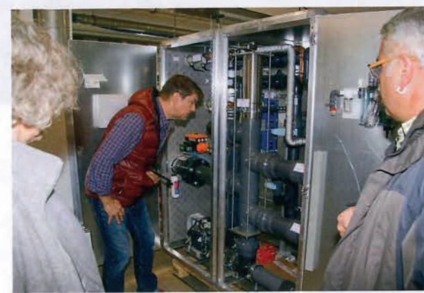
Blick in die „TopBoxx“: Der fertig installierte Technischrank wird bei Hofer exklusiv für die Topras-Händler hergestellt.
